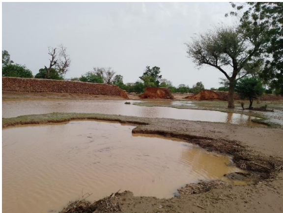
Les deux points de rupture de l'ancienne digue
